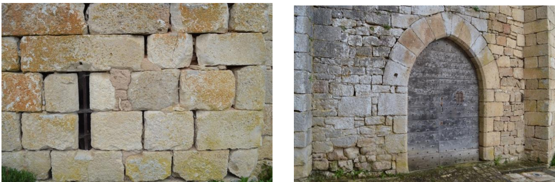
Château d'Ajat (XIV e – XVII e siècles) : détail de l'appareillage des pierres des murs montrant des hauteurs d'assises variables, une pose en joints décalés et par endroits des stries d'outils de taille. Entourage de porte réalisé avec des blocs taillés à façon. (Source : J.-J. Jarrige)
